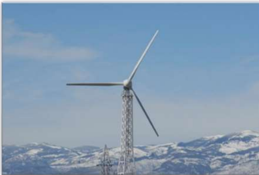
Figura 1. Aerogenerador Enercon E33.
