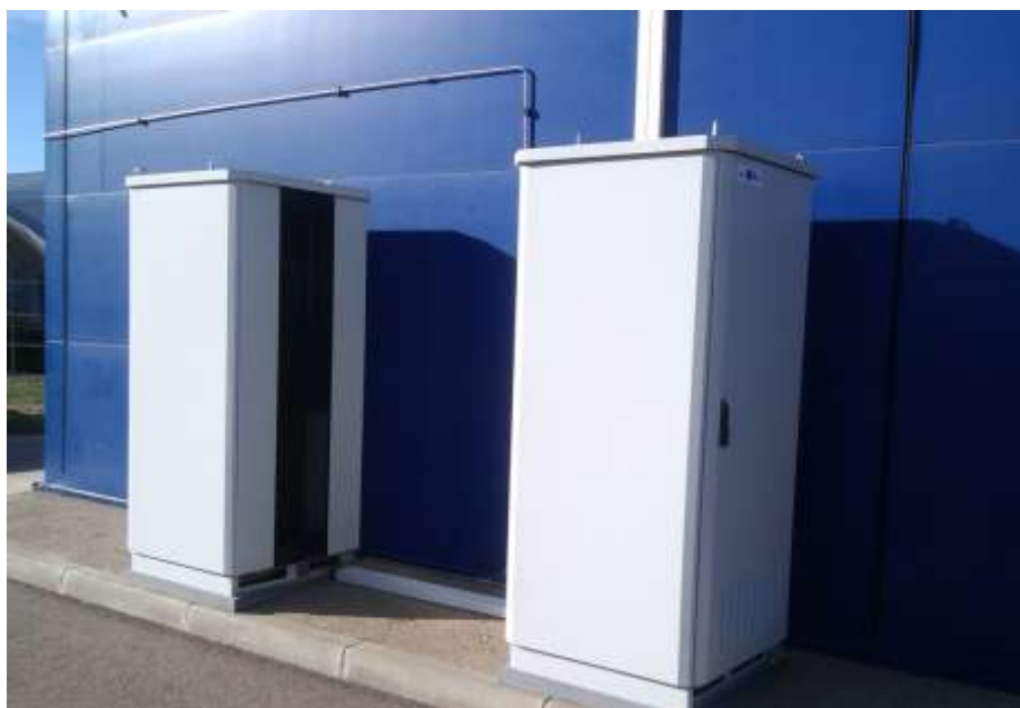
Figura 11. Pilas de combustible para reinyectar electricidad a la red.
