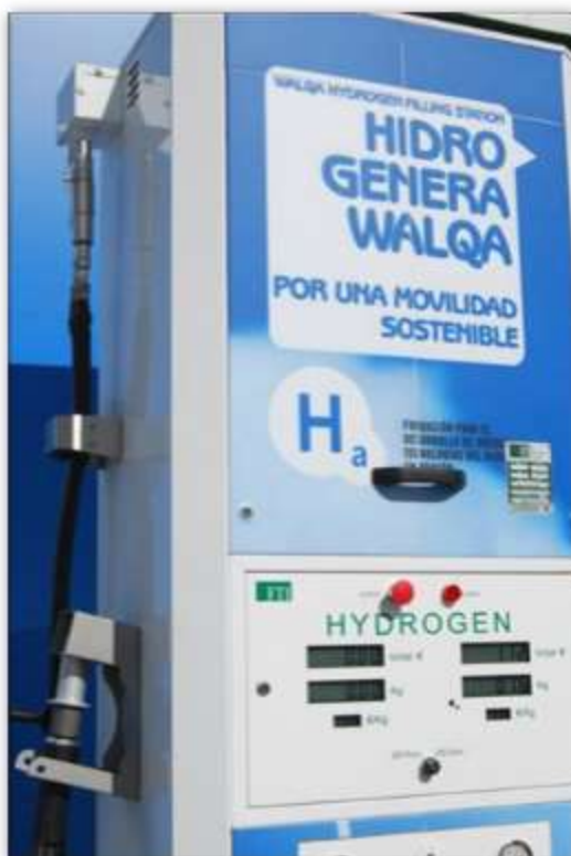
Figura 9. Estación de repostaje de vehículos de hidrógeno.
