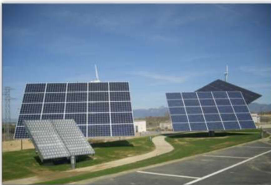
Figura 2. Seguidores solares en las instalaciones de la Fundación Hidrógeno Aragón.
