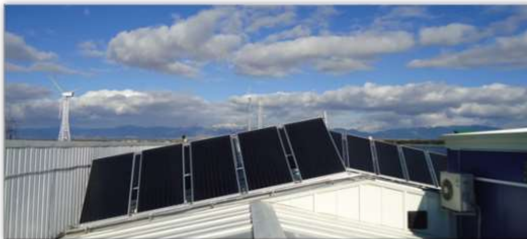
Figura 3. Captadores solares térmicos situados en la azotea.
