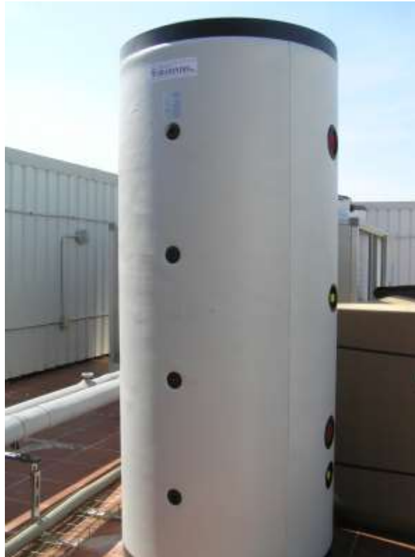
Figura 12. Acumulador solar de 1.000 litros
