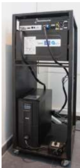
Figura 14. SAI con pila de combustible de hidrogeno
