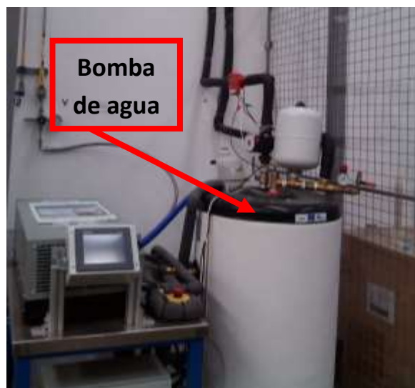
Figura 6. Detalle de la instalación de la pila de cogeneración y la bomba de la calefacción.
