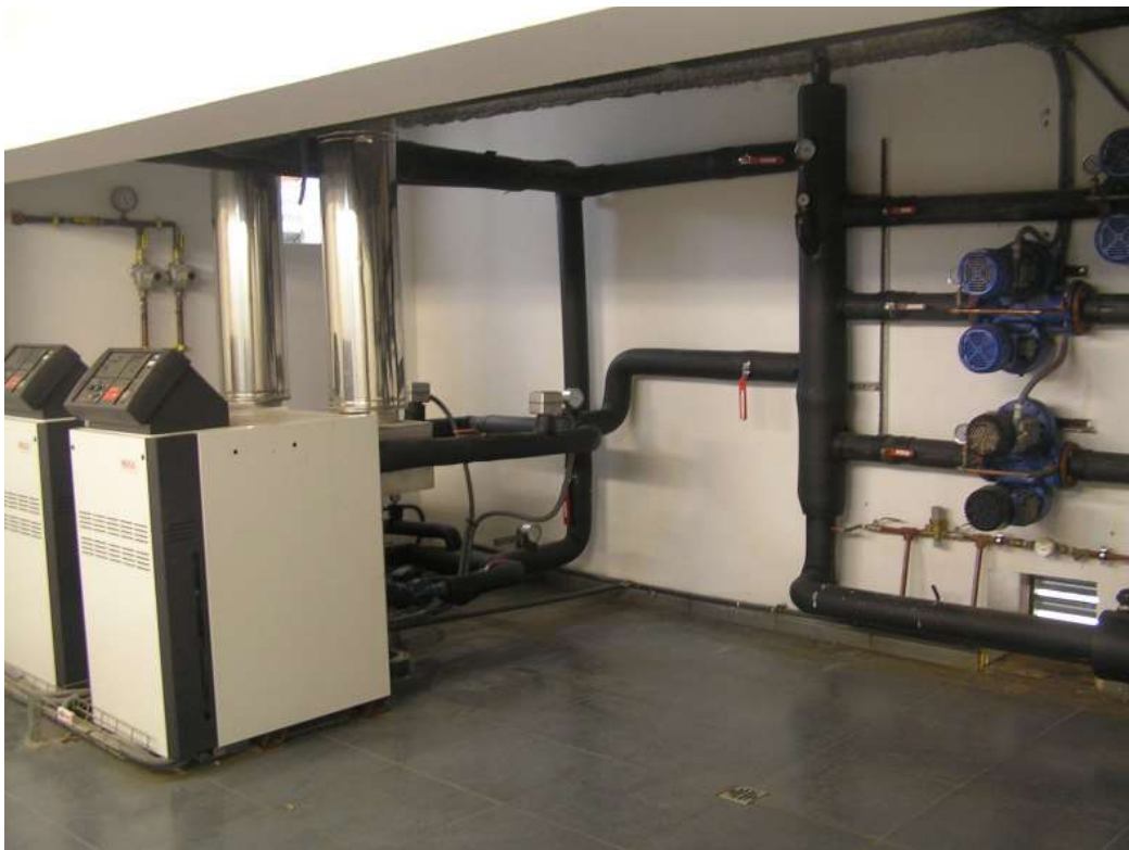
Figura 10. Cuarto de calderas del edificio
