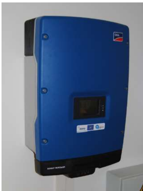
Figura 4. Inversor DC/AC SMA.
