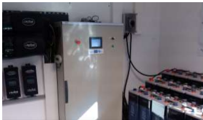
Figura 1. Baterías e inversores instalación aislada.
