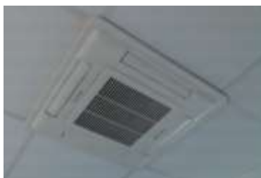
Figura 5. Fancoil en el techo del laboratorio.
